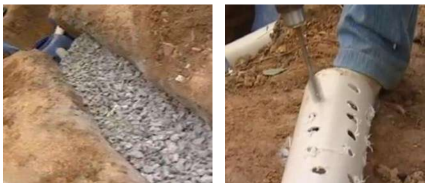
Figura 98 – Vala de infiltração para disposição do efluente da fossa séptica econômica
