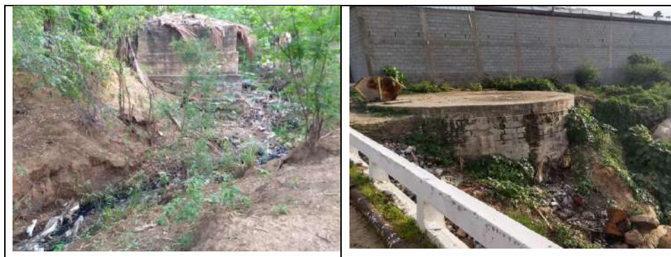
Figura 54 – Extravasamento do Esgoto sanitário das caixas coletoras da Sede de Anagé
