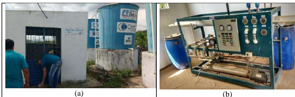
Figura 37 – Sistema de abastecimento de água por poços na comunidade de Cascavel
