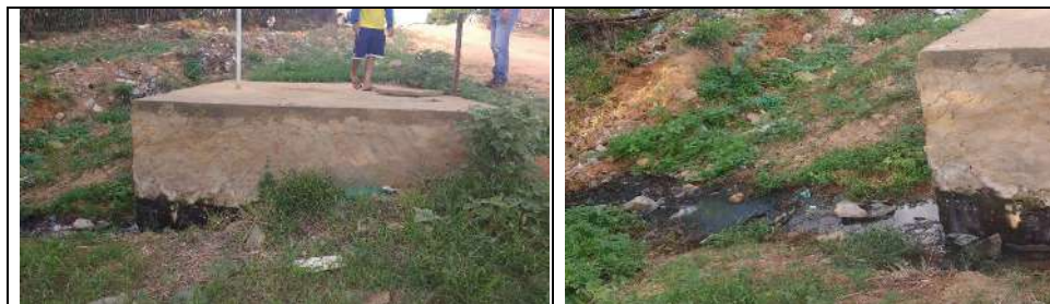
Figura 52 – Caixas coletoras na zona rural do Capinado
