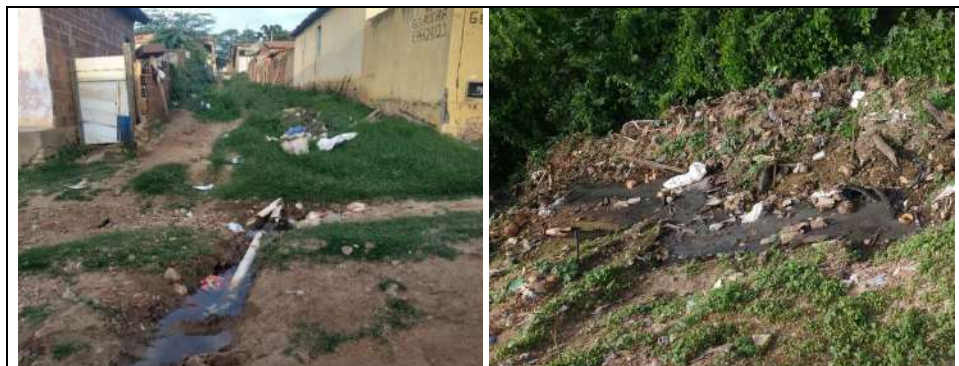
Figura 55 – Lançamento concentrado de esgoto in natura em Anagé
