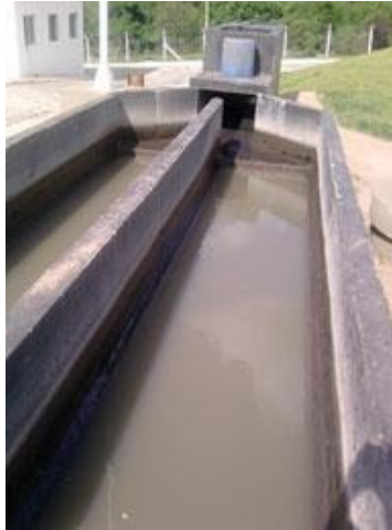
Figura 29 – Caixa de areia
