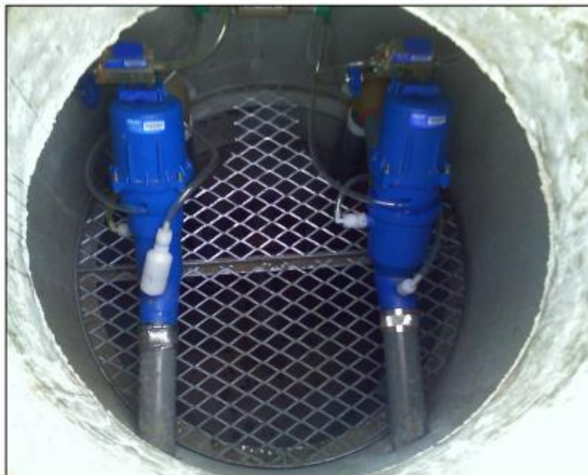
Figura 32 – Buffer Tank – Pré sedimentação
